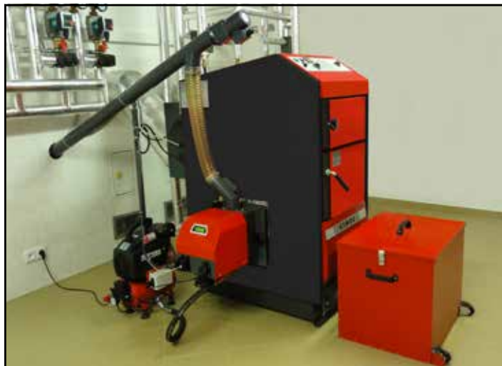
Příklad kotelny s kotlem D50P
